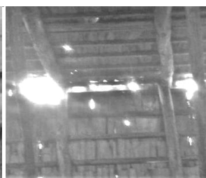
Fig. 78: Degradări ale învelitorii din draniță a clădirii cauzată de colonizarea cu mușchi a învelitorii.
