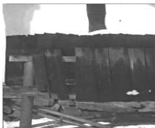
Fig. 84: Degradare a învelitorii gardului cauzată de apele provenite din ploaie și zăpadă.
