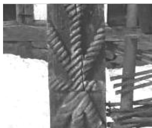
Fig. 83: Degradări ale stâlpului porții cauzate de umiditatea provenită din apele meteorice.
